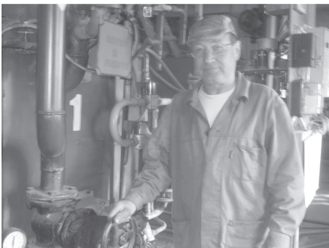
Котельные к зиме готовы ...
